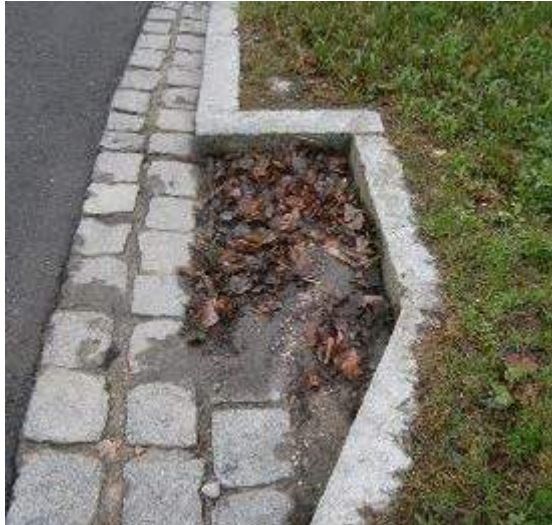
Bild 7: Beispiel - Einlauf vollständig verkleist
