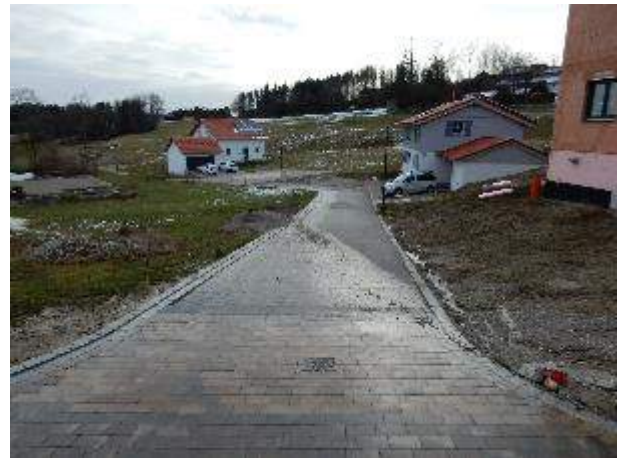
Bild 14: Ablauf Wasser Richtung Regenspeicher
